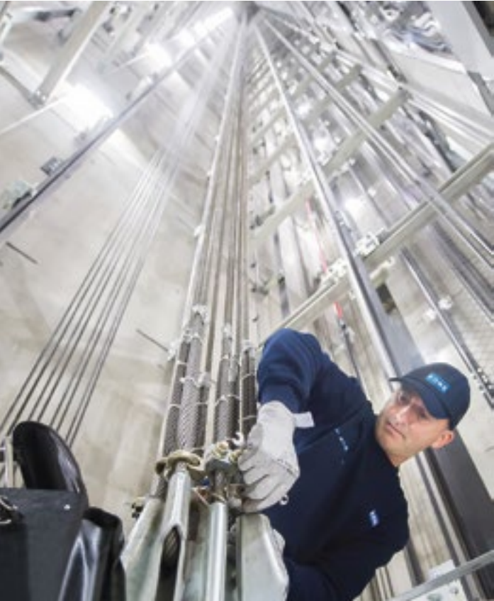
Der herstellerunabhängige, präventive und TÜV-zertifizierte Wartungsservice KONE Care® erfüllt alle Anforderungen der DIN 13015.
